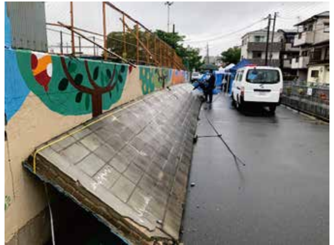
大阪府北部地震によって倒れたブロック塀
